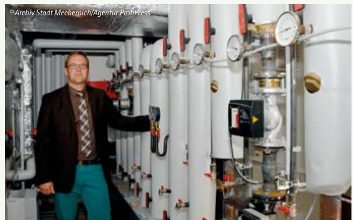
Wärmepumpenanlage im Keller des Rathauses in Mechernich
