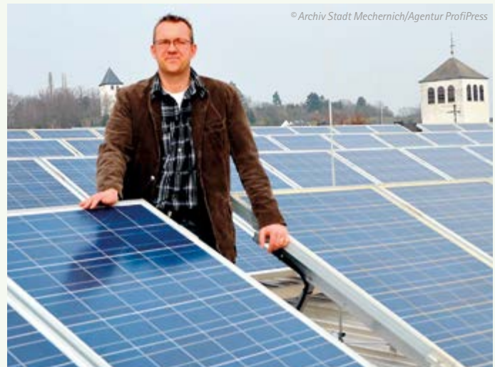
Solkollektoren auf dem Dach des Rathauses in Mechernich
